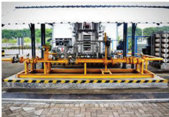
Gas Metering - Sidoarjo
